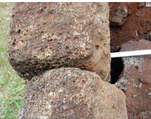
Paenga del muro frontal desprendida del concreto.
