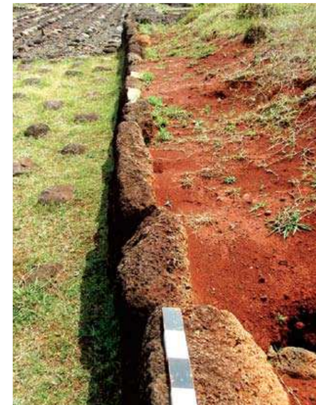
Vistas del muro frontal desalineado.
